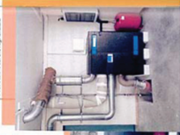
Un sistema di ventilazione geotermica per la distribuzione dell'aria negli ambienti
