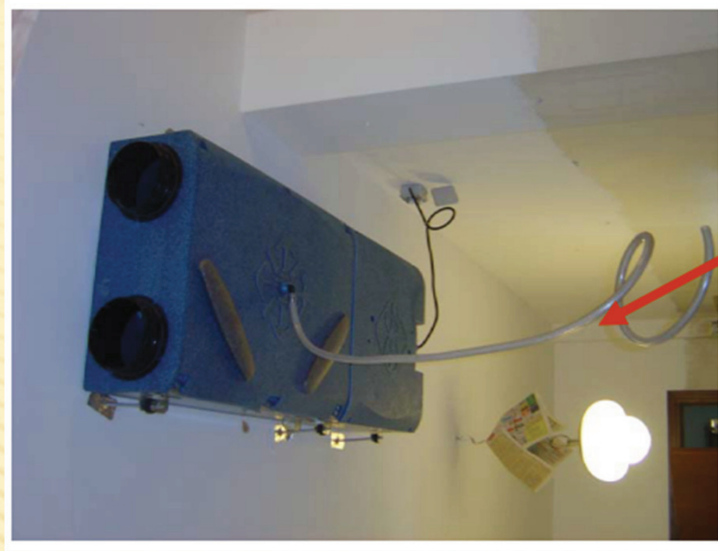
Vista dello scarico condensa.
