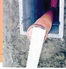
Luce di spezzone del sistema
